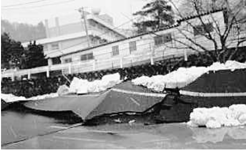
震災によって中学校のプールが割れ、隆起した道路は水浸しになった
